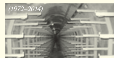
(1972–2014) Kabelové tunely v Praze
