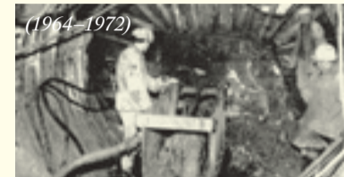
(1964–1972) Vodovodní přivaděč z Želivky do Prahy
