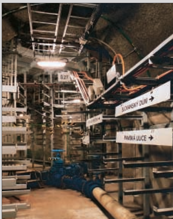
Kolektor Příkopy v centru Prahy
